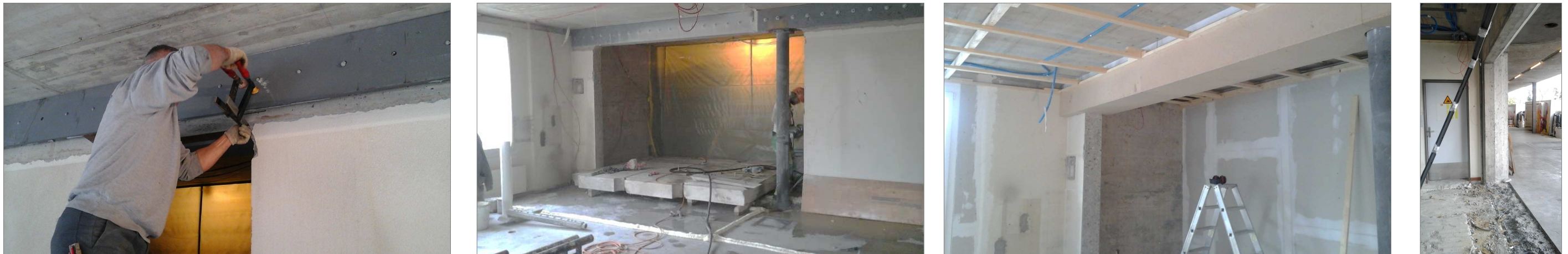
Bauphase: Vollstahlstütze 18 cm Durchmesser mit Kopf- und Fussplatte montiert unter Bestonsturz. Anschliessend auf beiden Seiten des Betonsturzes eine Vollstahlplatte geklebt und mit Gewindestangen fixiert.
